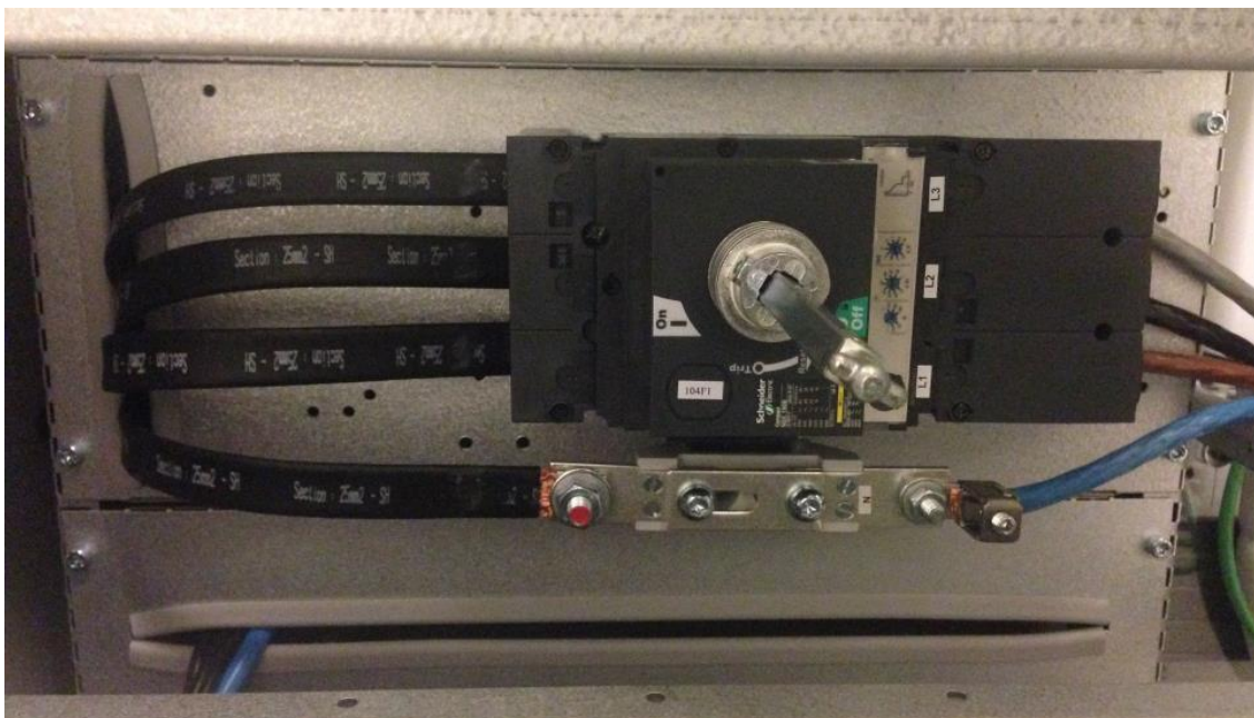
Figur 7 - Afgang større end 63 A som ikke er målt. Bryderen er forsynet med klemmer, således at afgangskabel kan monteres uden brug af pin bolte eller kabelsko. Bemærk at der ligeledes er anvendt klemme for nullederen.
