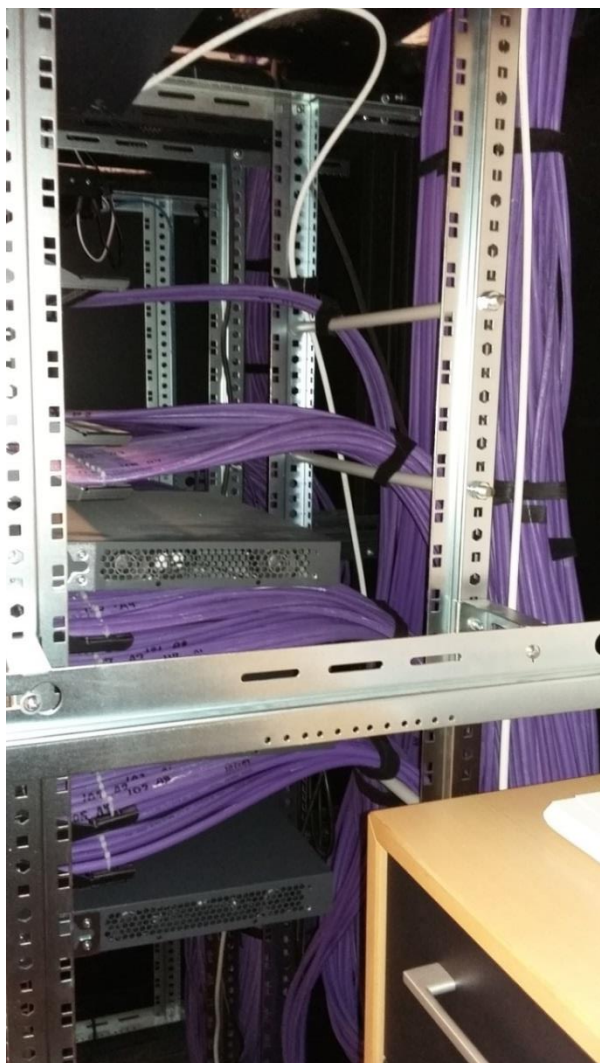
Figur 9 - Eksempel på korrekt føring og aflastning af PDS-kabler i IT-rack.
