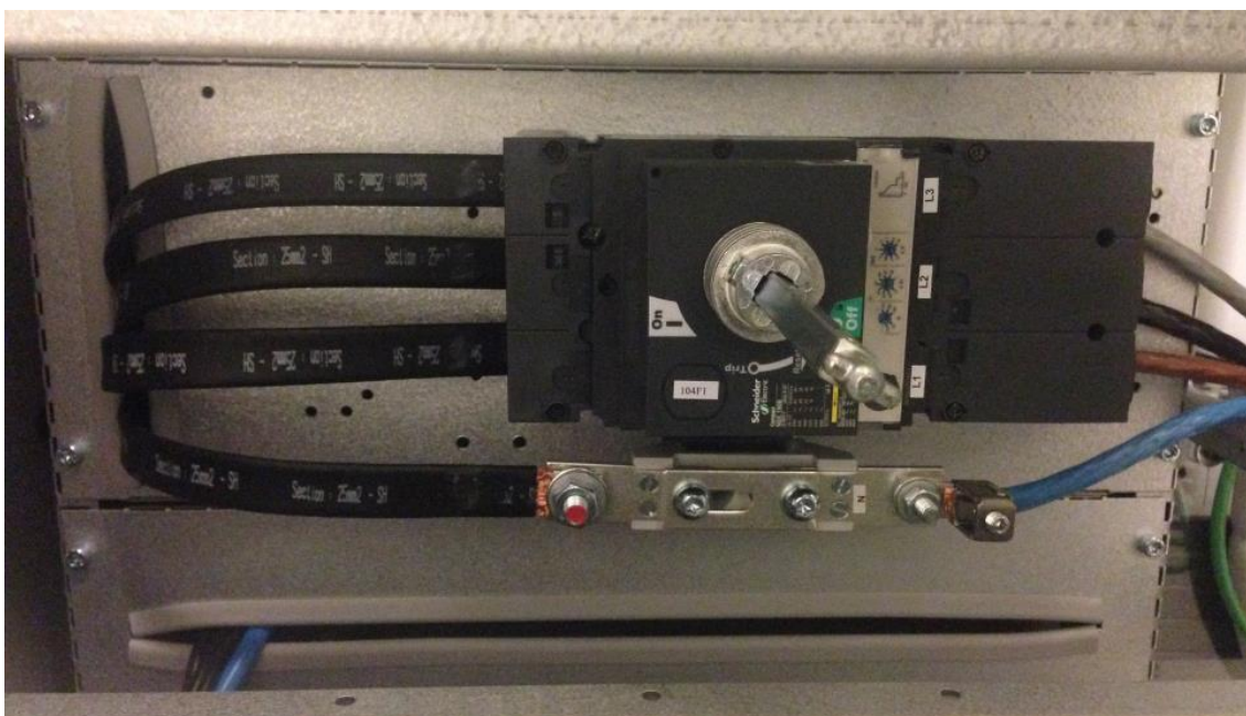
Figur 5 - Afgang større end 63 A som ikke er målt. Bryderen er forsynet med klemmer, således at afgangskabel kan monteres uden brug af pin bolte eller kabelsko. Bemærk at der ligeledes er anvendt klemme for nullederen.
