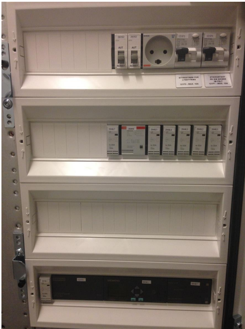
Figur 6 - Separat IBI felt, med komponenter som kun tilhører denne del af installationen. Der er placeret en servicestikkontakt i feltet, med egen kombiafbryder.
