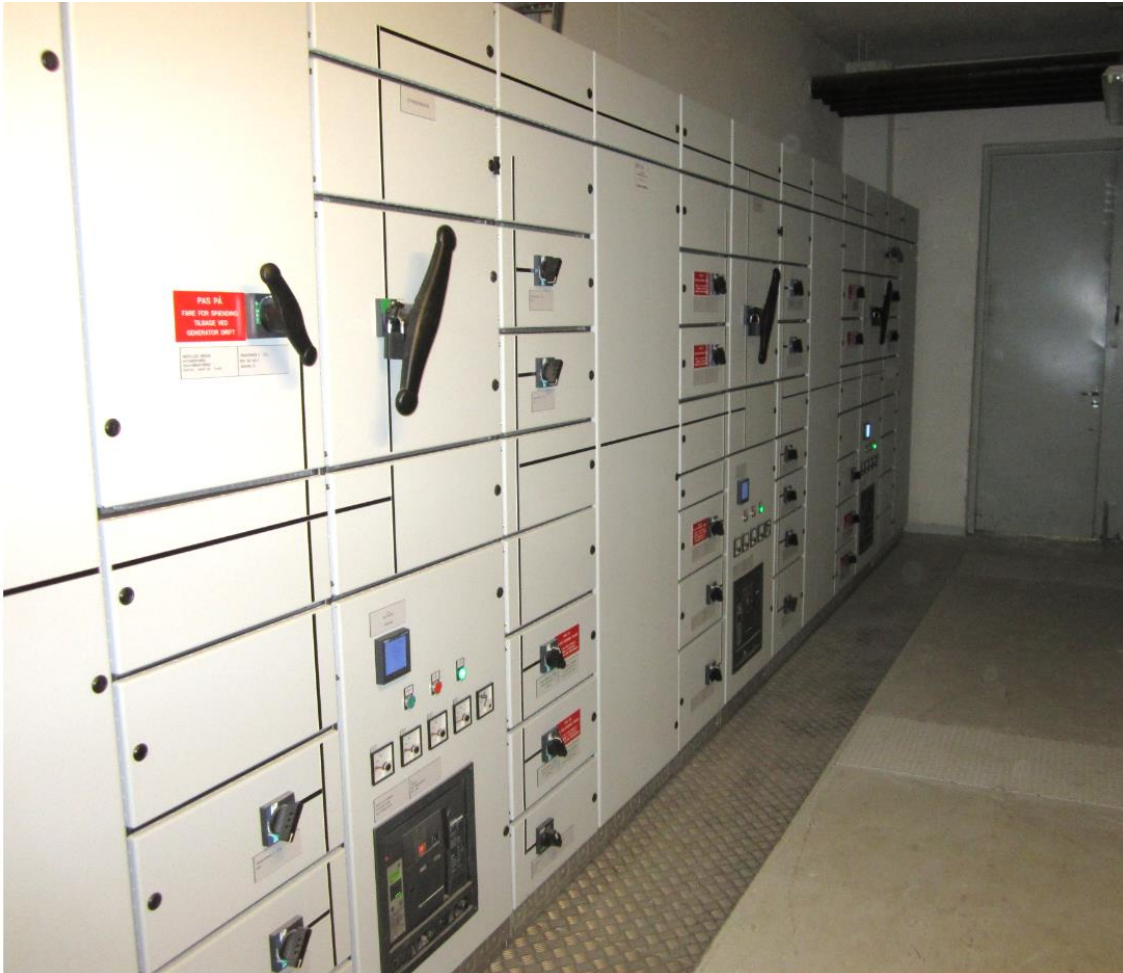
Figur 4 – Eksempel: 400 V transformertavlen i transformestation III. Bemærk de tre store tilgængsbrydere i bunden af tavlen, der indikerer, at der er tre transformere i stationen.
