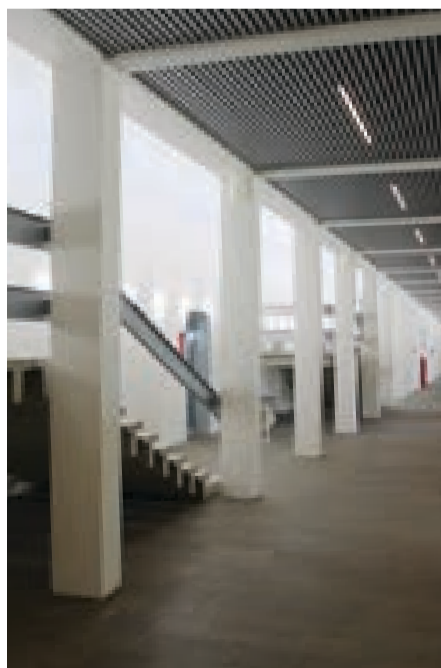
Renoveret interiør i B421 - Betonsøjler der tidligere har stået ubehandlet er blevet malet hvide - sammen med et nyt stålloft giver det en kølig materialitet. Foto: Praxis Arkitekter
