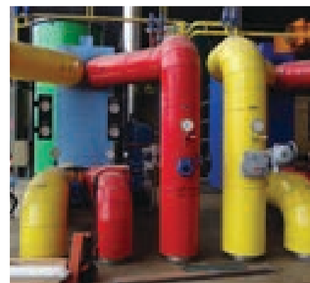
B415 - Kedelhal - Nyere farvesætning af rør Foto: Rørbæk Møller
